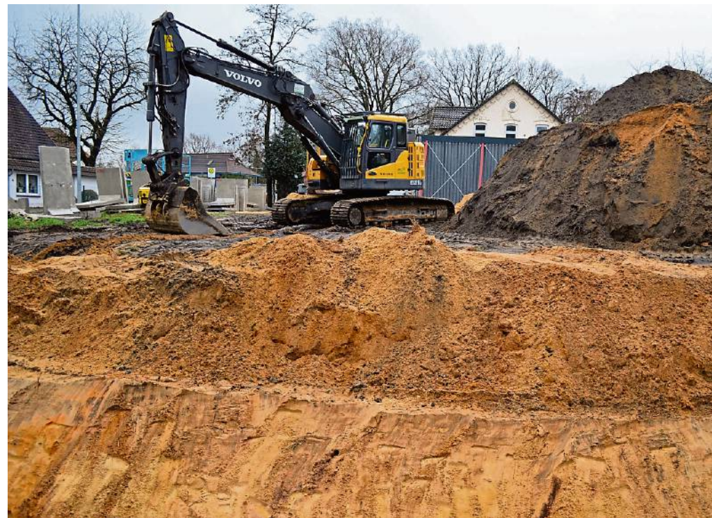
Das Gelände des THW an der Harmenhauser Straße soll zunächst mit Sand aufgefüllt werden, bevor im Februar die Bodenplatte geplant ist.
