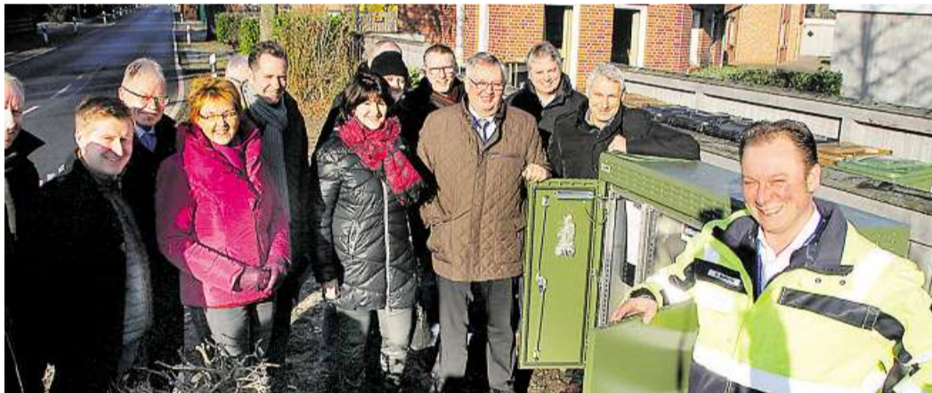
Breitbandausbau kommt voran: EWE-Projektleiter Daniel Böttcher (rechts) stellt Vertretern der Gemeinden und Abgeordneten einen Kabelverzweiger vor.
